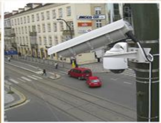
KAMEROVÉ SYSTÉMY CCTV SYSTEMS
